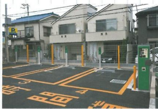
各駐車スペースに設置された課金用のボールに、30万画素のカメラを内蔵し車のナンバーを撮影。ロック板がないため、心理的に安心して駐車できる。
